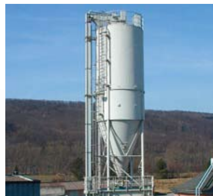
Silobeschickung durch ein Winkelbecherwerk mit Klärschlammgranulat.
