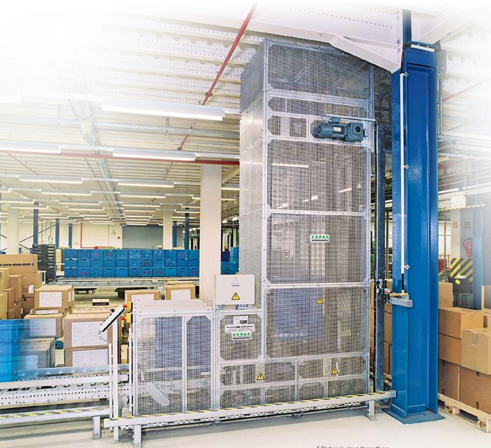
S-Förderer in einem Versandlager
